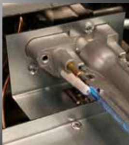
Termopar y bujía situados fuera de la fuente de calor
